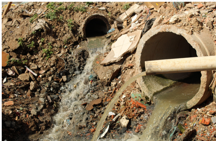
FALTA DE SANEAMENTO: Esgoto a céu aberto em Paraisópolis
